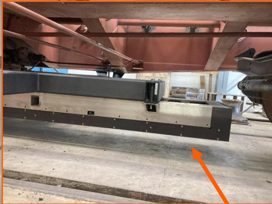
Stator zwischen den Schienen
